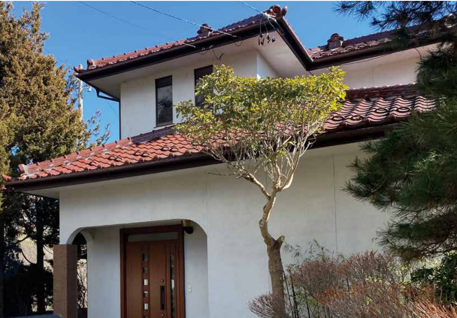
外観 | 窓廻りモルタル補修 床下 | 防腐・防蟻処理 玄関 | 断熱親子ドアに交換
